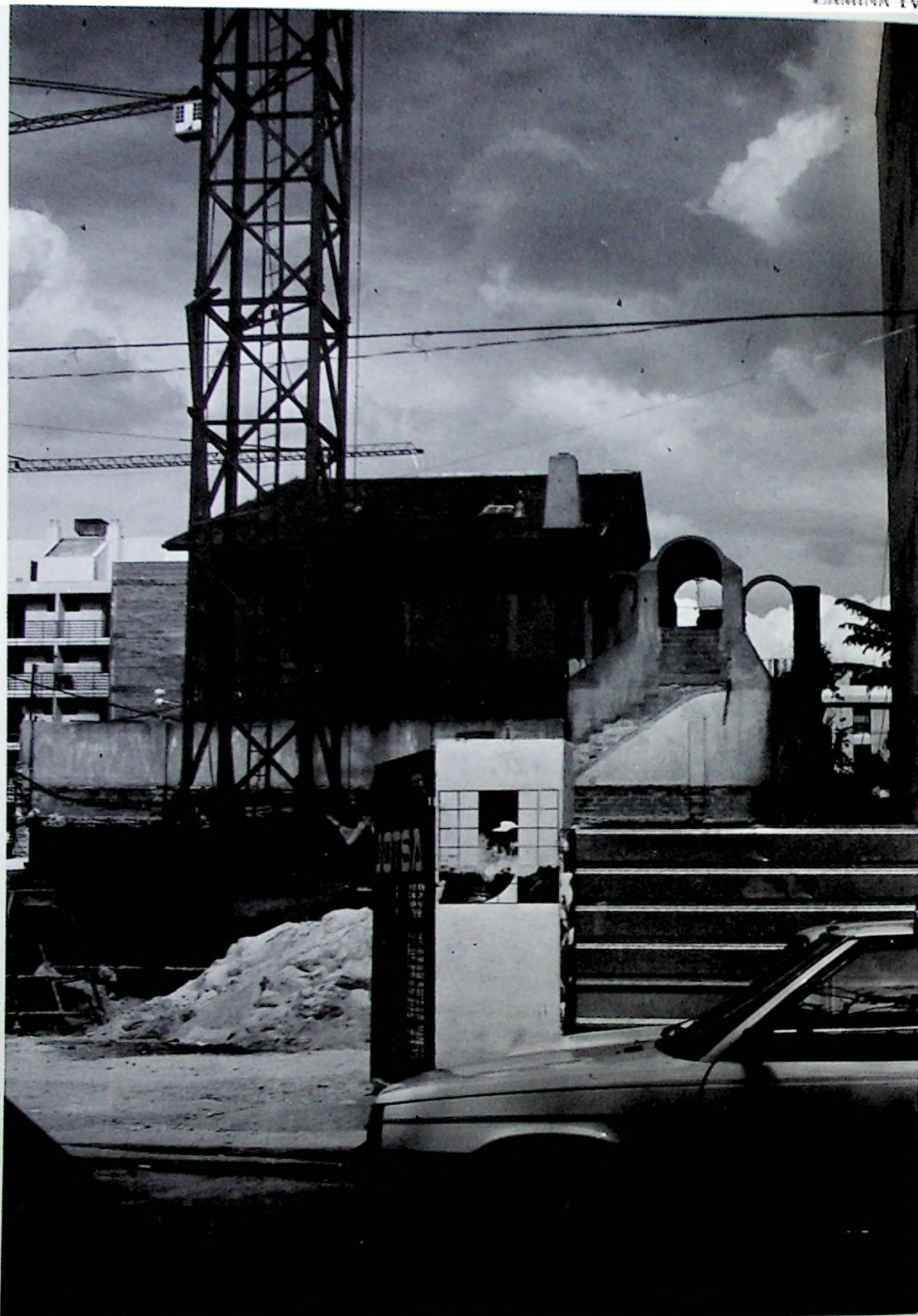
Calle Alenza. Destrucción de la Colonia Maudes. Al fondo se distinguen las obras comenzadas de la nueva promoción Géminis.
