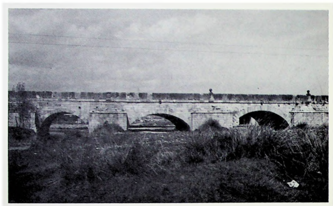
Fig. 1. Estado actual del puente de Viveros.
