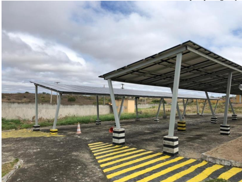
Figura 5 – Placas fotovoltaicas instaladas no estacionamento do Campus para geração de energia.
