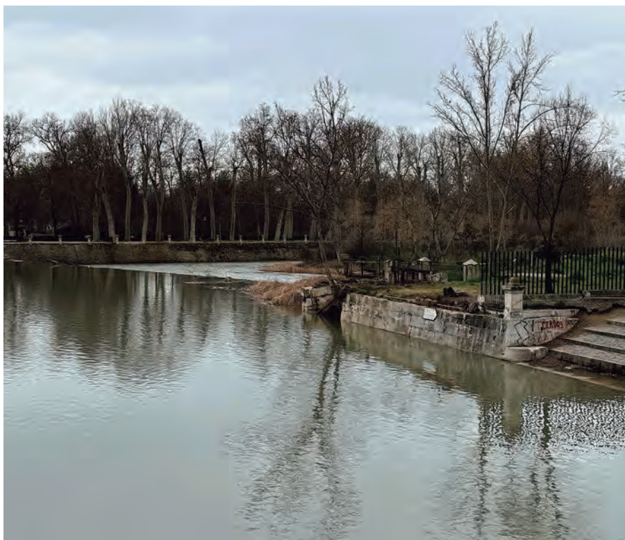
14. La entrada del canal Este desde el río. Fotografía propia.
