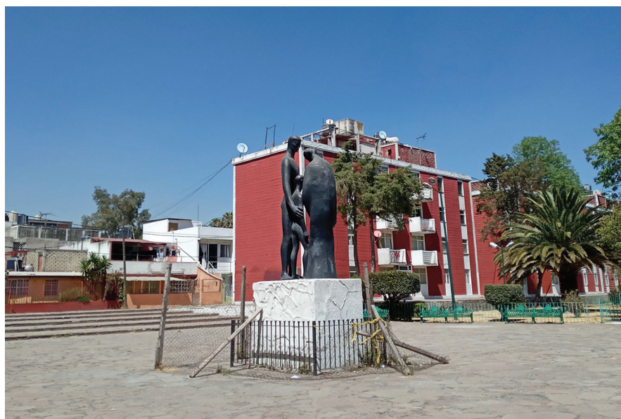
FIGURA 2. APUNTALAMIENTO INFORMAL DE LA BASE QUE SOSTIENE LA FAMILIA , DE CHARLOTTE YAZBEK
