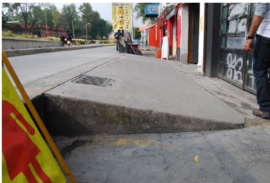
Figura 8. Rampa de acceso vehicular sobre la acera. Colonia Centro, Ciudad de México. Fuente: Ruth Pérez López.
