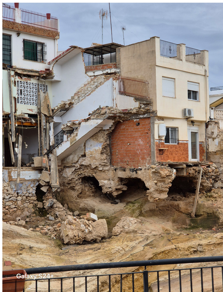
Figura10: Edificios arruinados junto al barranco en Chiva. La energía de la riada ha recuperado el cauce ocupado ancestralmente por edificaciones, dejándolas literalmente en el aire. Fuente: El autor.
