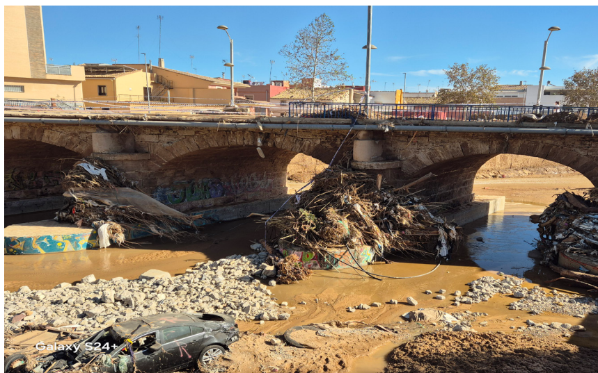
Figura 2: Puente de la Carretera Real de Madrid sobre el Barranco del Poyo, entre los municipios de Catarroja y Massanassa. Entre lo sólidos arrastrados por el flujo que limitaron la capacidad de desagüe se encuentran muchos restos de vehículos. El puente de la fotografía, de finales del XVIII, ha venido resistiendo las sucesivas riadas sin daños estructurales aparentes. Fuente: El autor.
