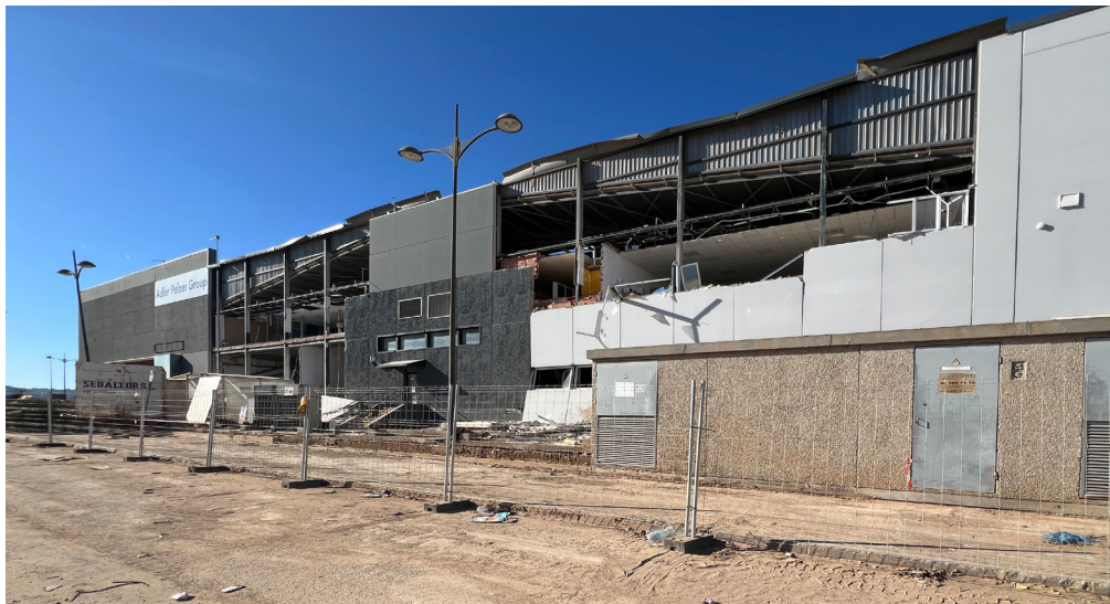
Figura 11. Nave industrial afectada por la DANA. Fuente: foto de los autores.
