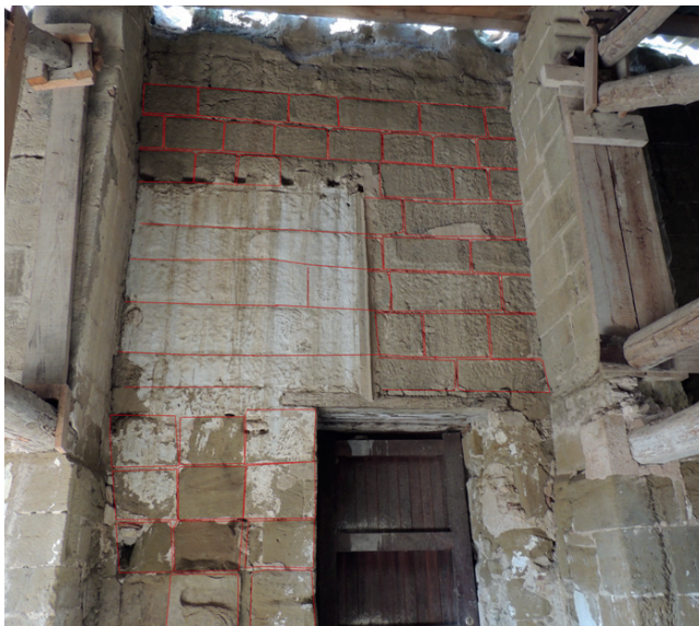
Figura 24. Lienzo situado junto a la cata 7 (muro B en figura 15). Se observa un interesante sistema constructivo, más próximo a obras andaluzías que a paramentos propios del estilo románico.
