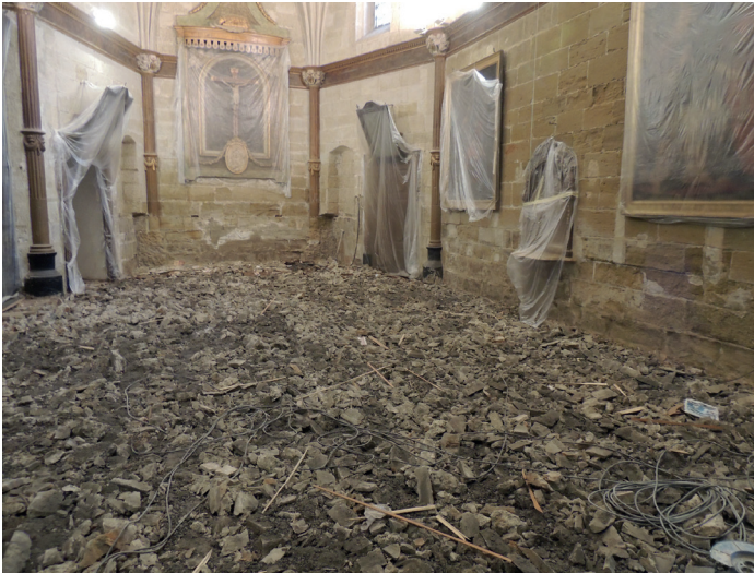
Figura 8. Aspecto general de la sacristía nueva o mayor después de que se retirara la tarima debido a su mal estado.
