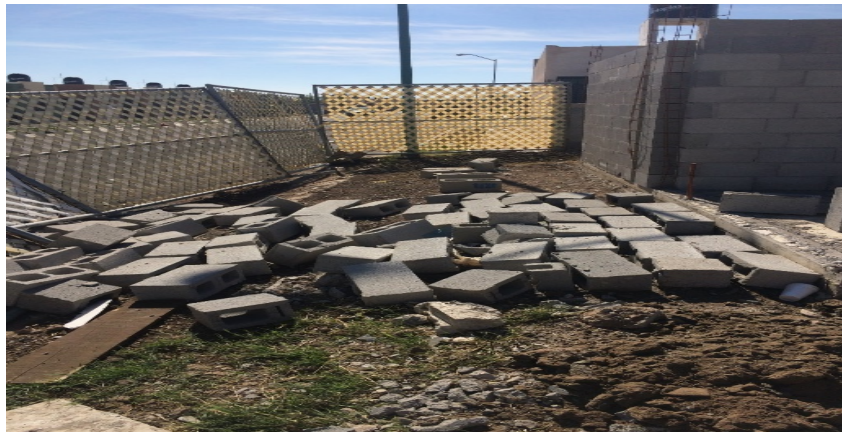
Figura 10. Muro caído (Fuente propia).
