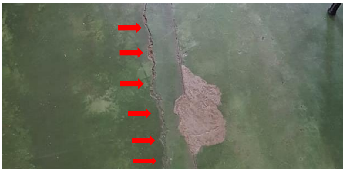
Figura 16 – Rebaixamento da laje do prédio 2, observada na biblioteca.
