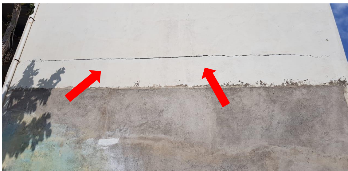
Figura 14 – Fissura horizontal no prédio 2.
