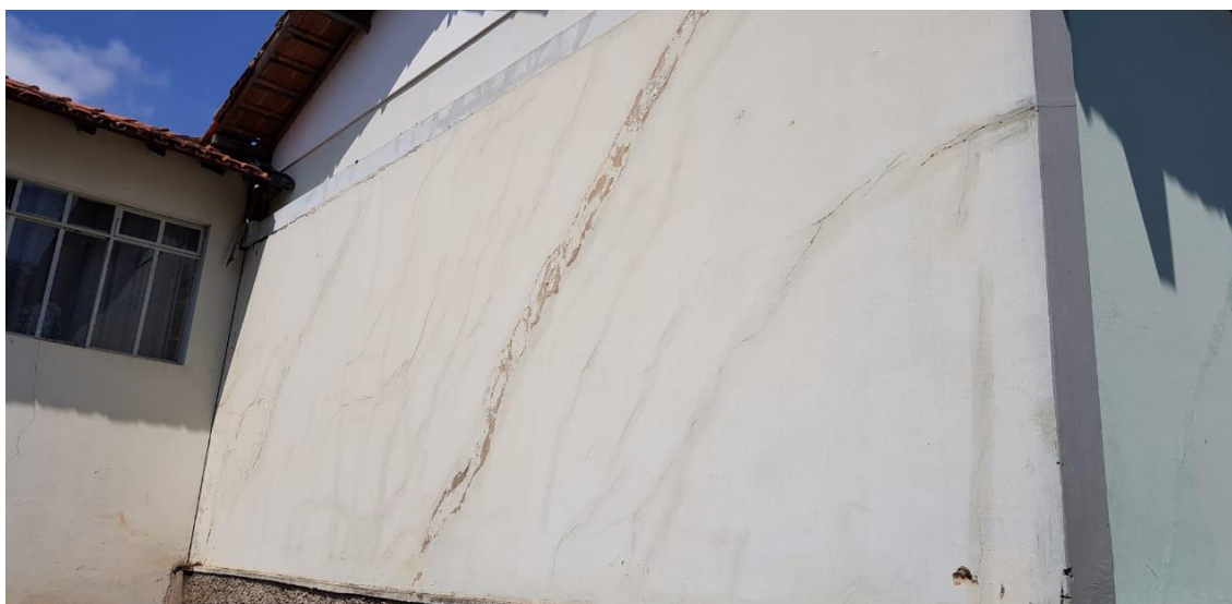
Figura 08 – Fissuras inclinadas na alvenaria de vedação externa.
