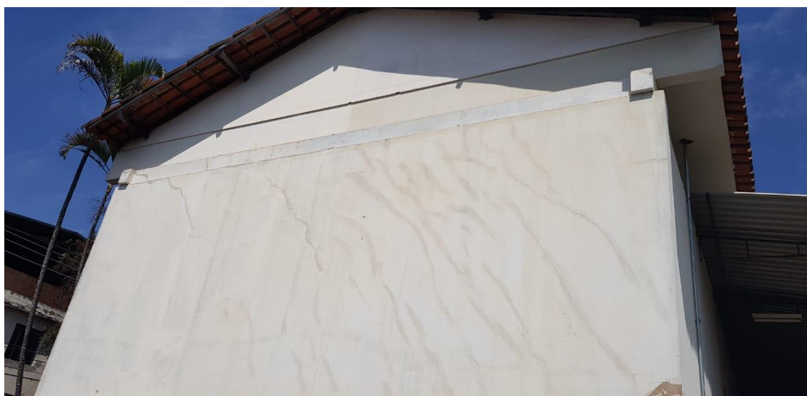
Figura 07 – Fissuras inclinadas na alvenaria externa de vedação.
