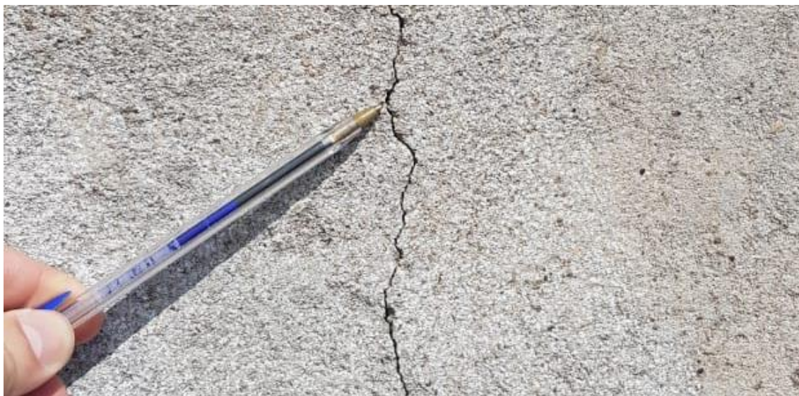
Figura 13 – Detalhe da fissura vertical na alvenaria na parte externa da sala.
