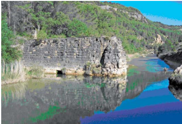
Figura 1. Pantalla de la presa con su zona derrumbada.
